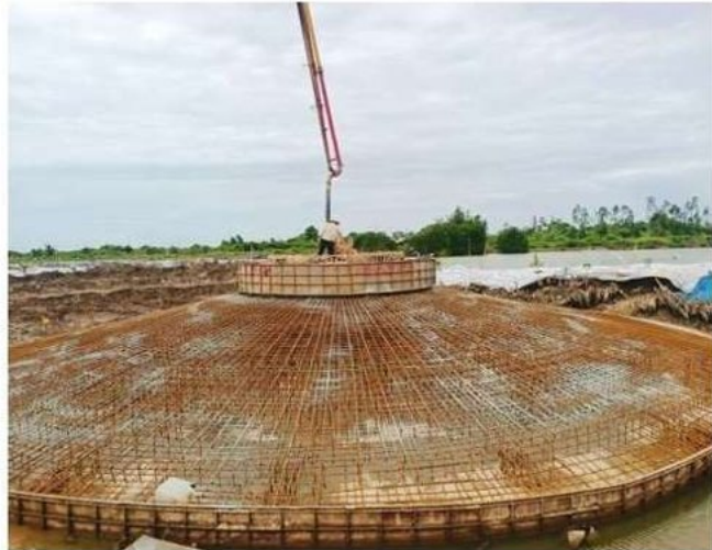
Điện gió Bạc Liêu
