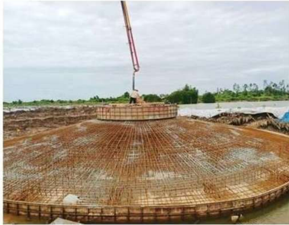
Điện gió Bạc Liêu
