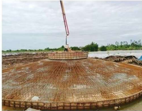
Điện gió Bạc Liêu
