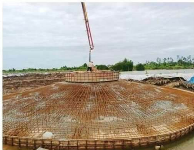
Điện gió Bạc Liêu
